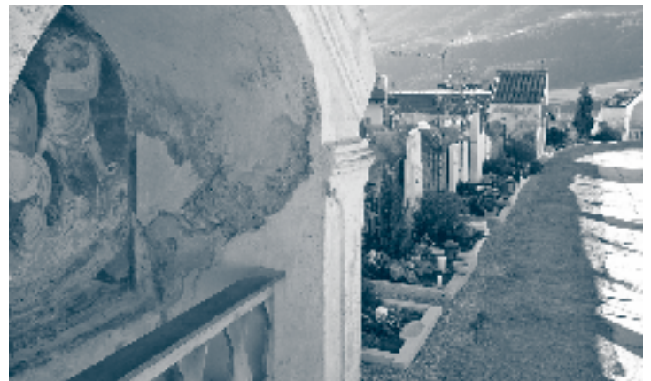
Die beschädigten Kreuzwegstationskapellen am Friedhof in Kortsch
